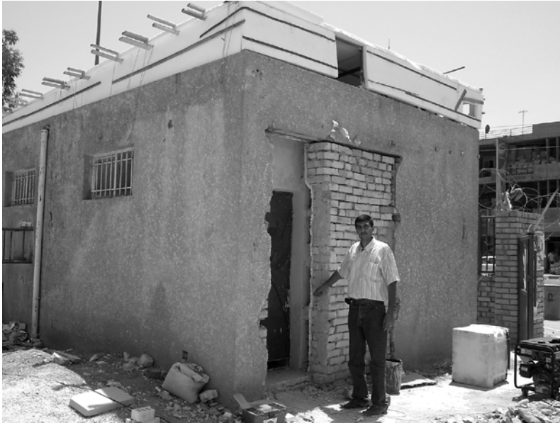
صورة خارجية لغرفة التجارب ويظهر فيها العازل الجداري قرب الباب وفتحة دخول الهواء الى المبردة في الاعلى
